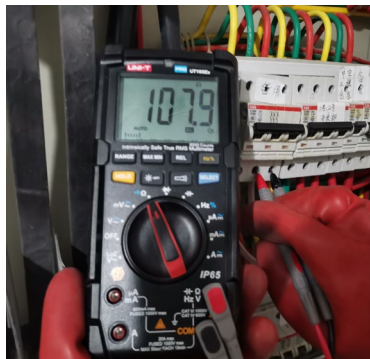
电阻档施加380V电压
