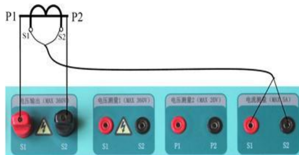
④ CT 升流保持 (使用内置电源) 测量方案 1
